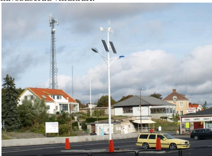
Foto: Kommunens parkeringsbelysning som drivs av sol- och vindel
